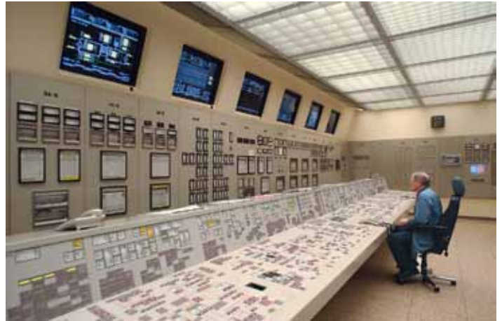
Wenn automatisierte Systeme und Menschen zusammenarbeiten – hier in der Leitwarte des Kernkraftwerks Obrigheim
